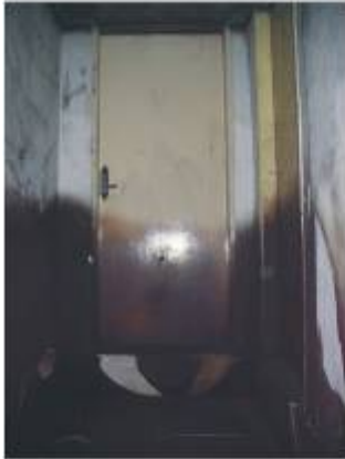
Foto 74: andar do apartamento que pegou fogo. Fonte: DÉBORA SANCHES, 2007
