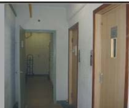
Foto 130: hall com os elevadores Fonte: SANCHES, 2007
